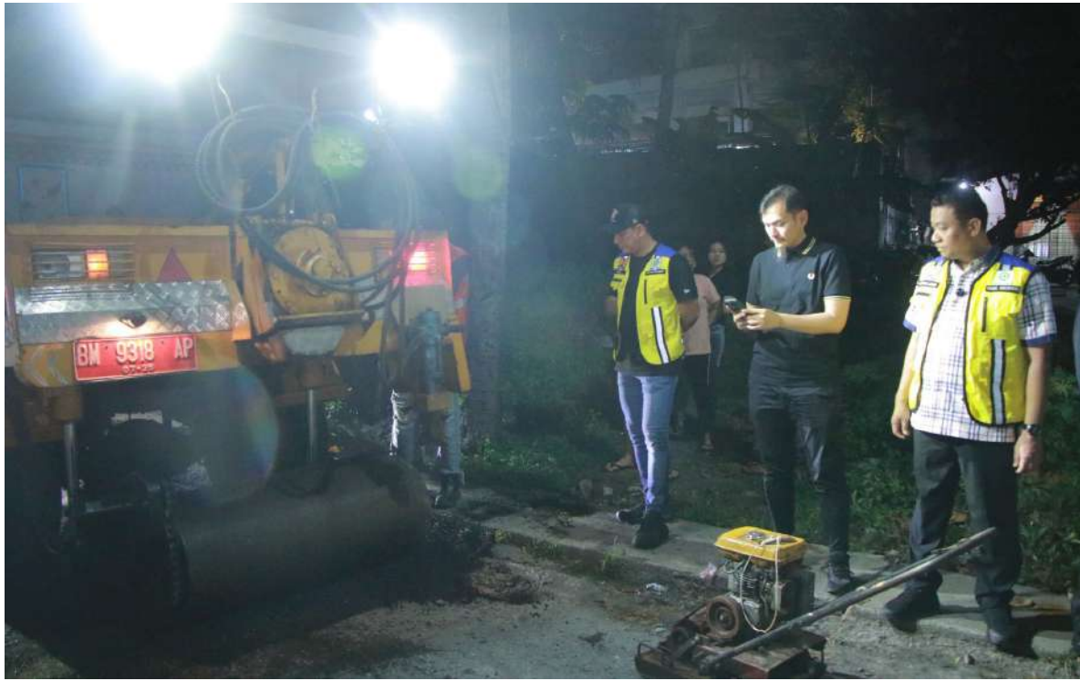
TAMBAL JALAN - Wakil Wali Kota H Markarius Anwar ST March meninjau tambal sulam jalan berlubang di Kota Pekanbaru.
